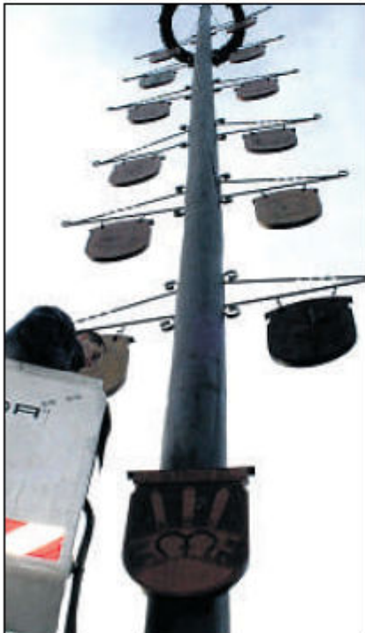
Pilzbefall: Der Simmershäuser Maibaum muss abgebaut werden. Foto: Grigoriadou
